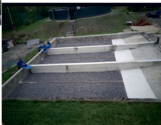
Odkaliště na ČOV
